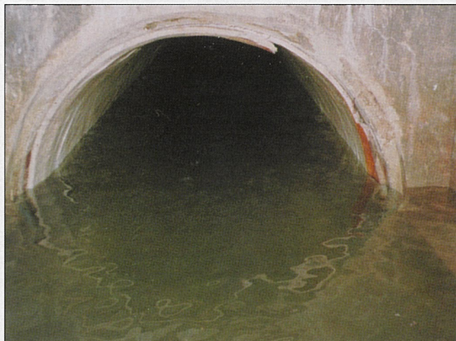
管口状況 管端部一部欠落
